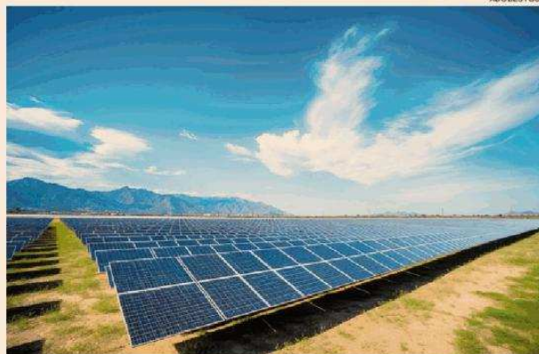
Fotovoltaico. Uno dei casi più frequenti in cui scatterà il prelievo è la costituzione del diritto di superficie
