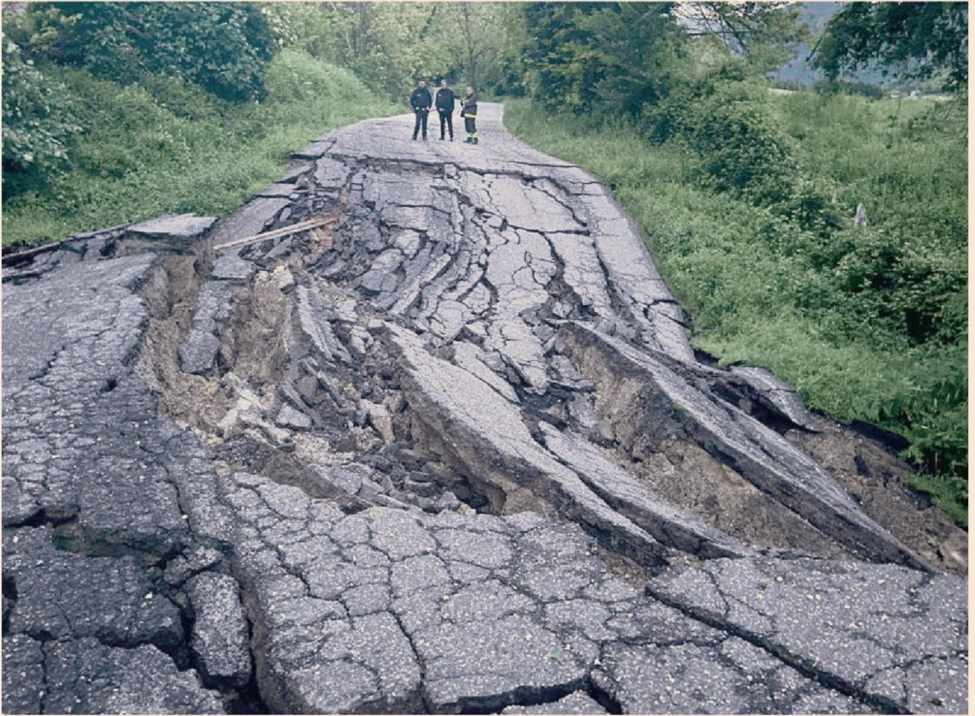
Bagno di Romagna. Il sopralluogo effettuato su una strada dissestata dopo una frana dovuta al maltempo, il 20 maggio scorso
