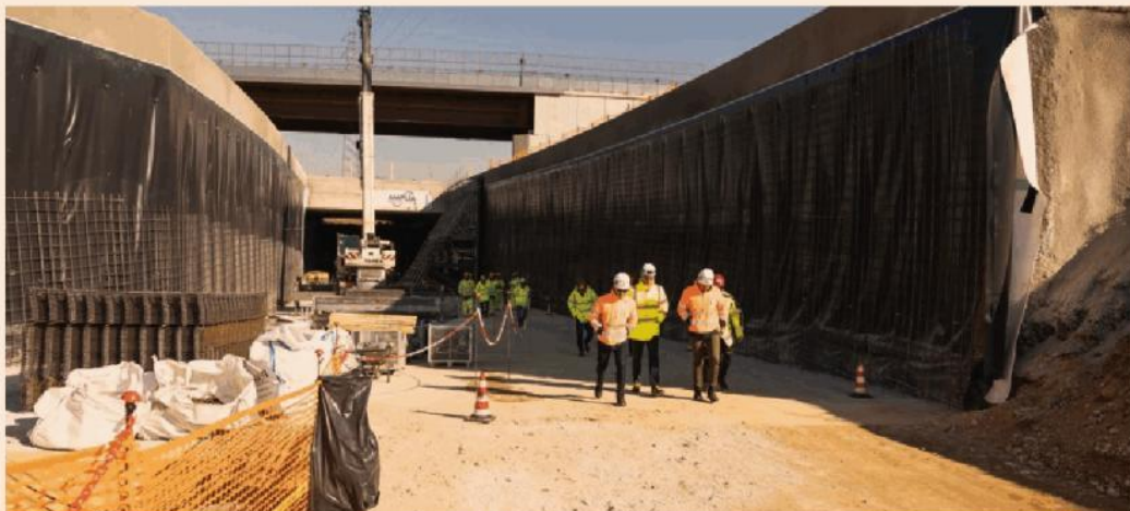
Milano Nord. Il cantiere per la realizzazione della quinta corsia lungo l'autostrada A8 Milano Laghi: completamento dopo l'estate
