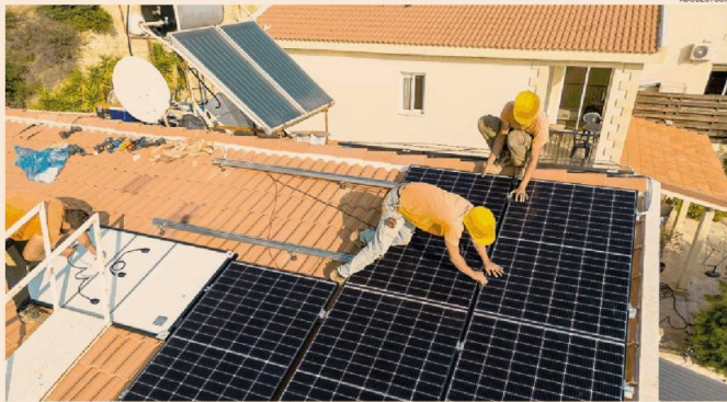
Incroci di agevolazioni. L'installazione dei pannelli fotovoltaici è premiata sia dal superbonus sia dalla detrazione del 50%
