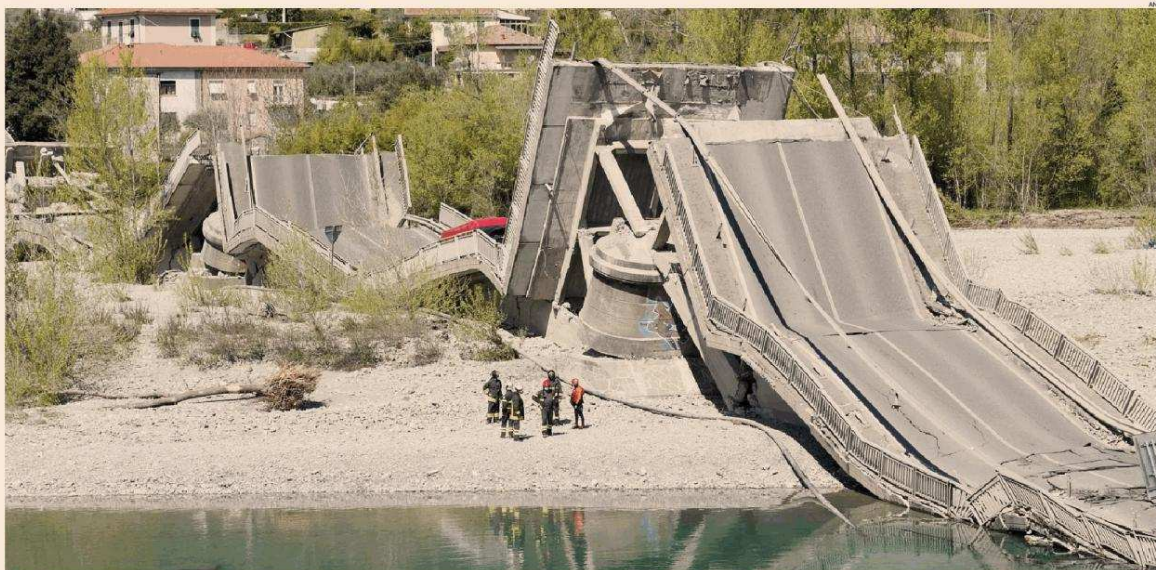
Non solo autostrade. Anche la rete della viabilità ordinaria è in grave sofferenza. Lo scorso 8 aprile intorno alle ore 10,30 ha ceduto di schianto il ponte di Albiano Magra, che collega il paese, in provincia di Massa Carrara, con Santo Stefano Magra (La Spezia). Il ponte è uno snodo di collegamento importante tra la Liguria e la Toscana. Nel crollo sono rimasti feriti due uomini in transito coi loro furgoni
