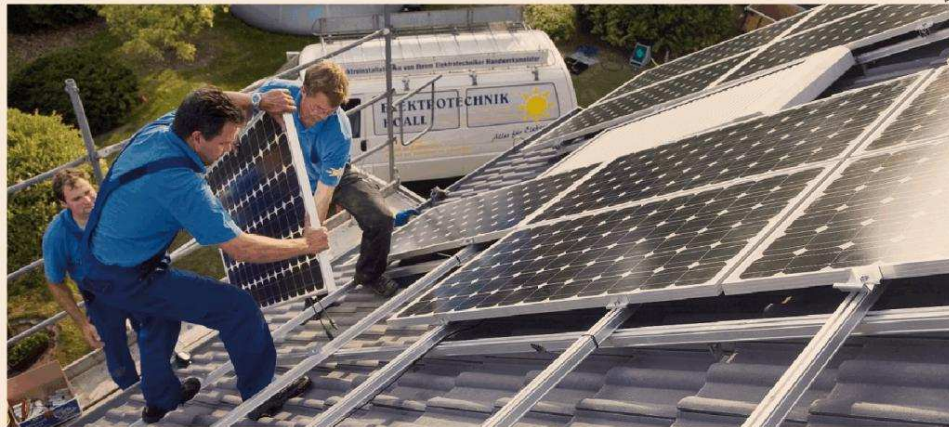
Fotovoltaico. Superbonus del 110% anche per l'installazione di impianti fotovoltaici (nella foto) connessi alla rete elettrica fino a un massimo di spesa non superiore a 48mila euro
