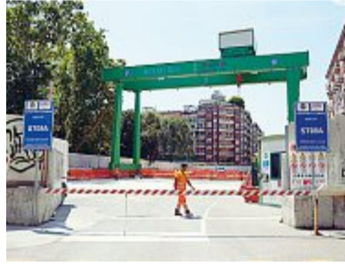
Il quartiere Nella foto in alto, i danni prodotti dal passaggio della Tbm del metrò 4 in viale Coni Zugna 15. Qui sopra: il palazzo e il cantiere al parco Solari (foto Piaggese)
