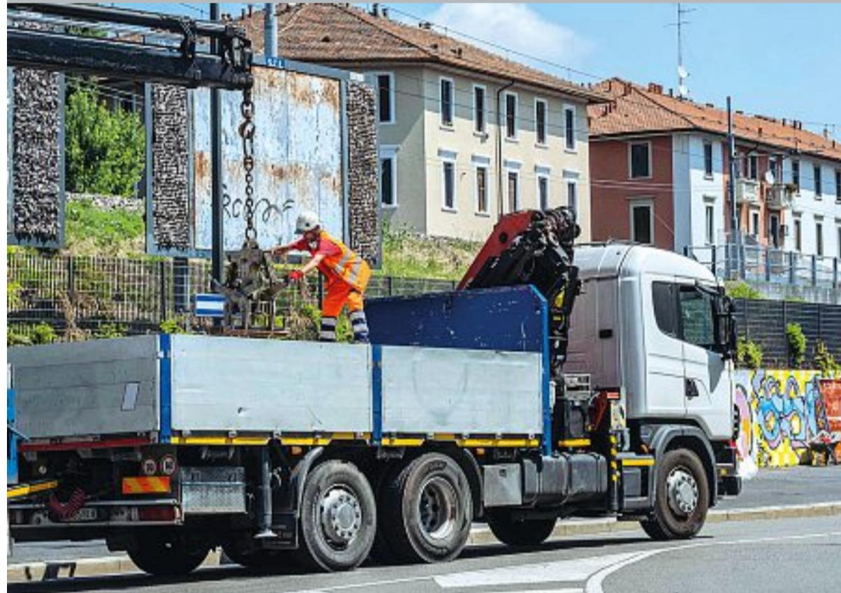
Circle line La nuova infrastruttura ferroviaria sarà dotata di pareti verdi e barriere antirumore per evitare disagi ai residenti (foto Bozzo)
