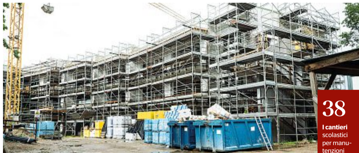
In costruzione I ponteggi che circondano la scuola di via Ugo Pisa, tra via Bisceglie e via Inganni (foto De Grandis)
