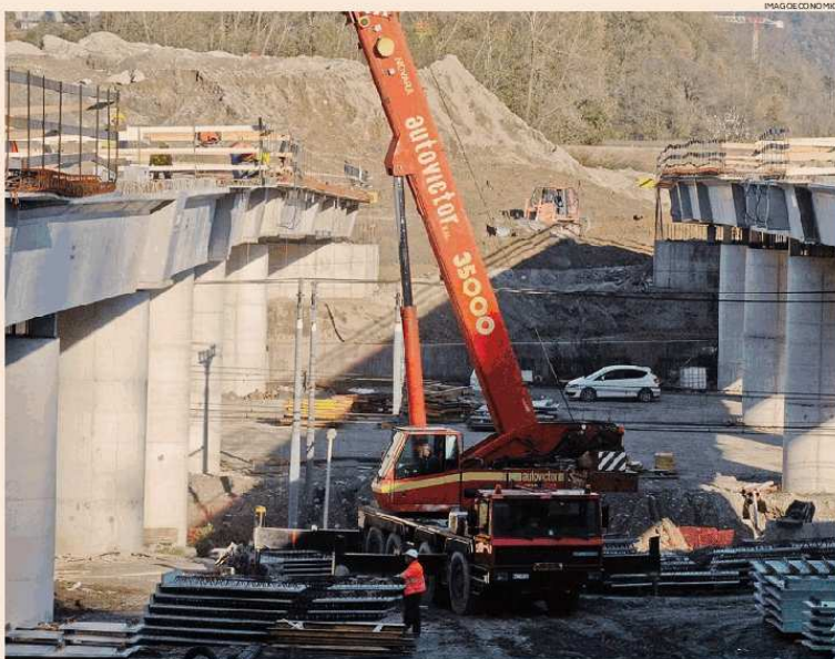
Grandi opere. Nella foto del 2013 il cantiere della Pedemontana tra la tangenziale di Como e Grandate
