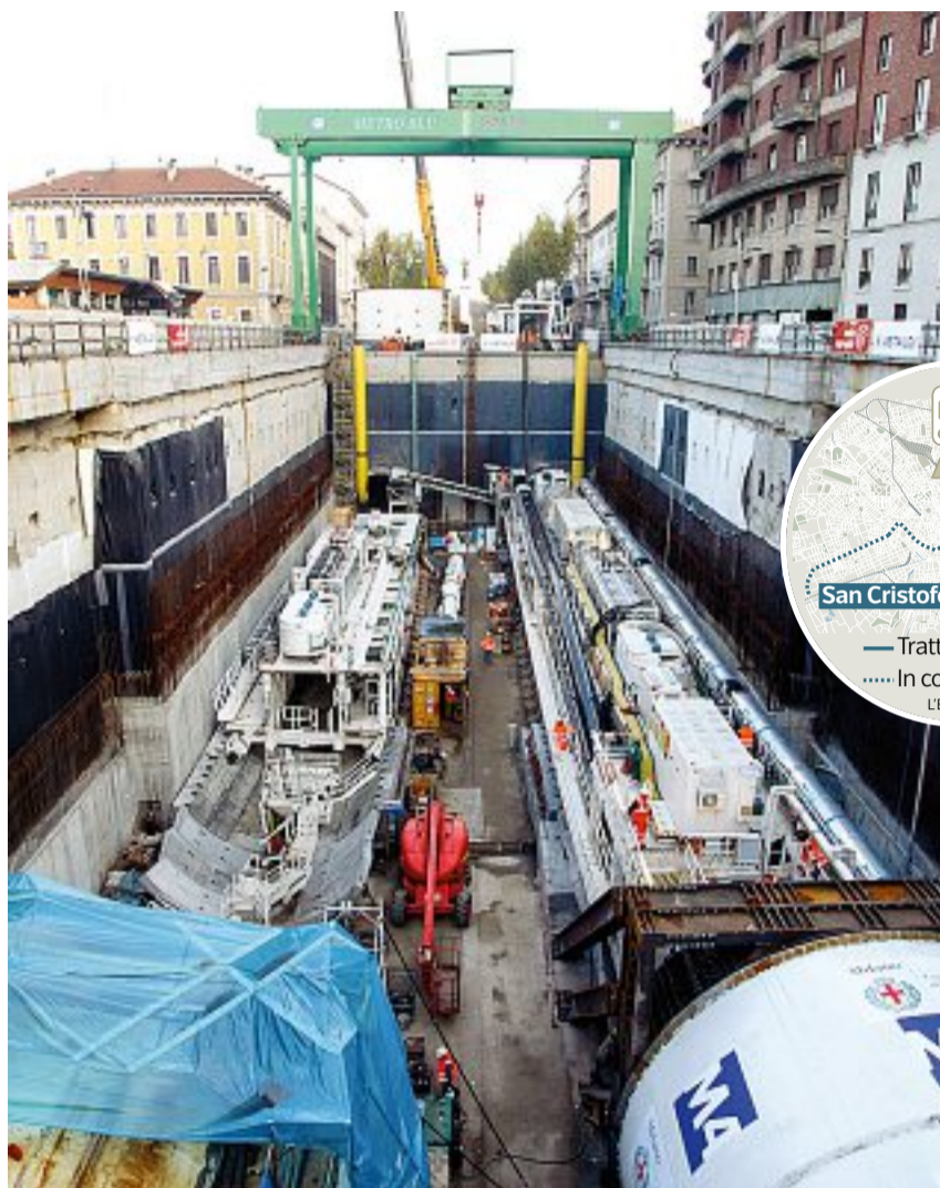
La trincea L'avvio della talpa meccanica il 5 dicembre scorso nello scavo di piazza Tricolore (LaPresse)
