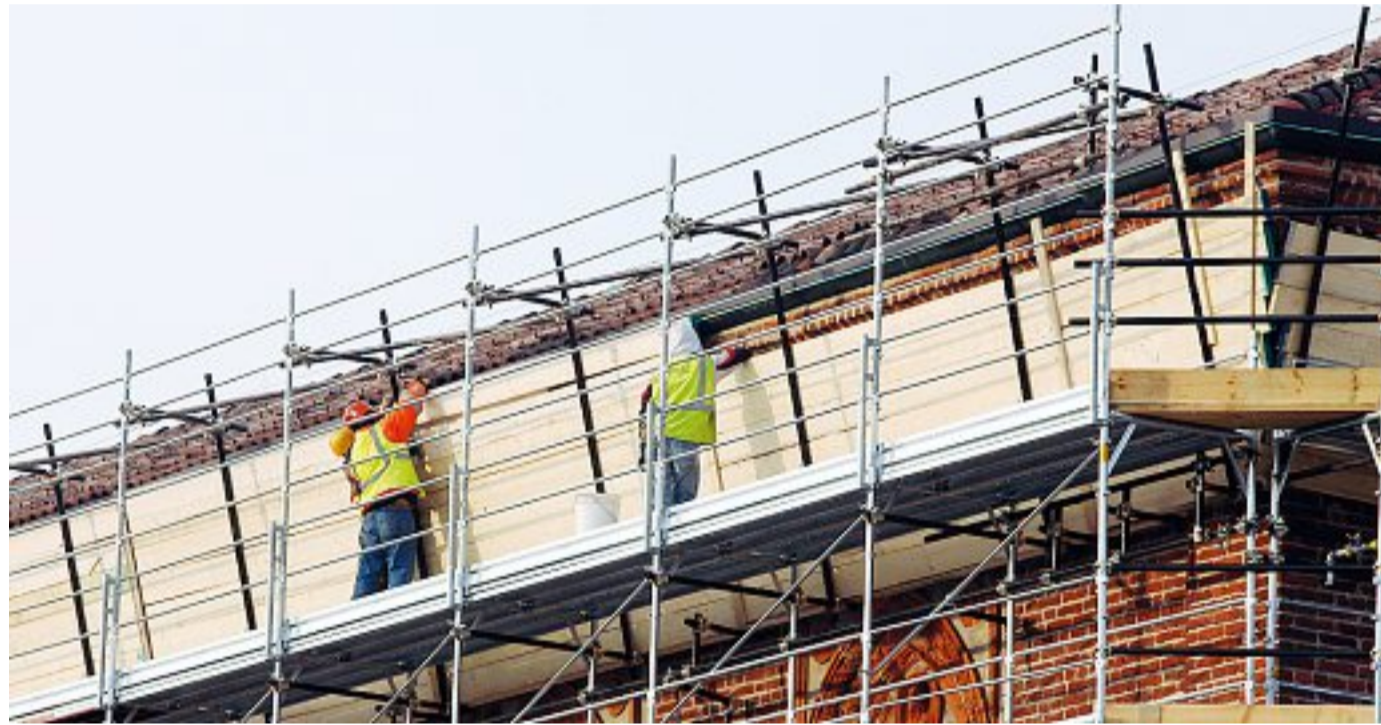
Fermata Sforza-Policlinico Gli operai della linea metropolitana blu (M4) al lavoro per «impacchettare» la Ca' Granda a tutela dell'edificio (foto Gerace)
