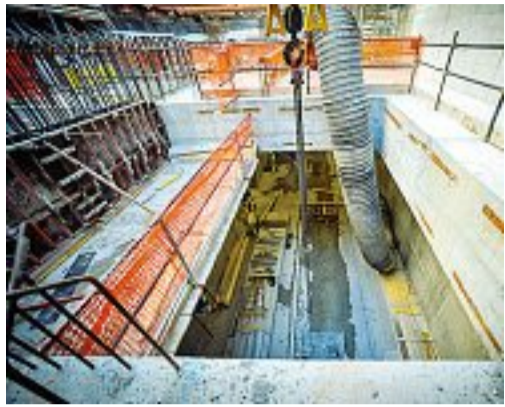
Infrastruttura Avanzano i cantieri per la costruzione della linea blu del metrò
