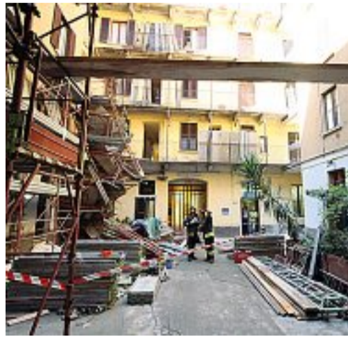
Il crollo In via Mangone, l'11 settembre, hanno ceduto i ponteggi del cantiere di ristrutturazione di un palazzo: è morto un operaio irregolare (Fotogramma)
